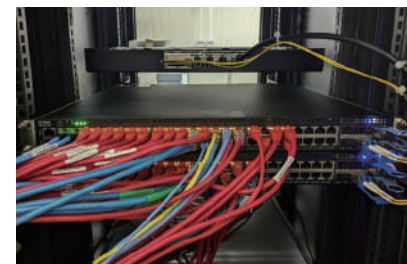
▲ サーバルームに設置された L3 スイッチ（正面）
