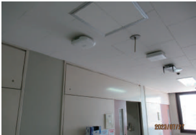
▲病棟に設置された無線アクセスポイント
