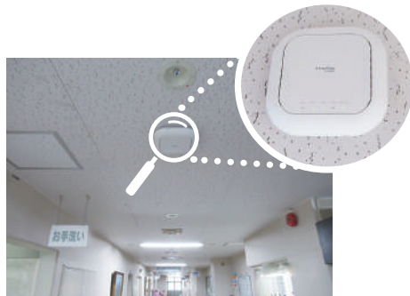
▲廊下の天井に設置されているNuclias Cloud対応の無線アクセスポイント「DBA-2520P」
