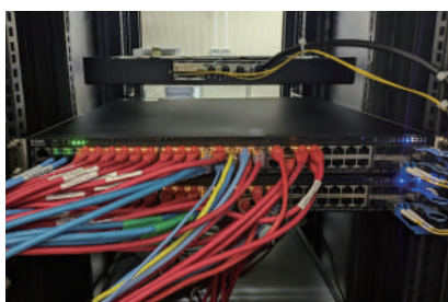
▲ サーバルームに設置された L3 スwitch（正面）
