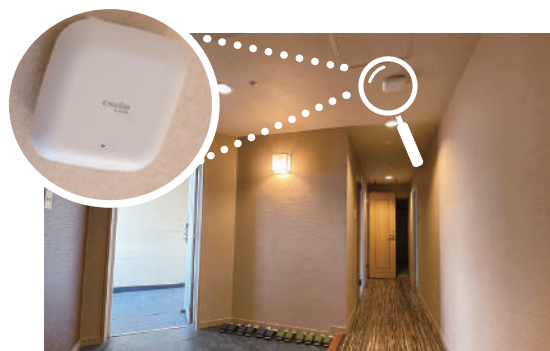
▲客室玄関付近の天井に設置されている、Nuclias Cloud 対応の Wi-Fi 6 無線アクセスポイント「DBA-X1230P」
