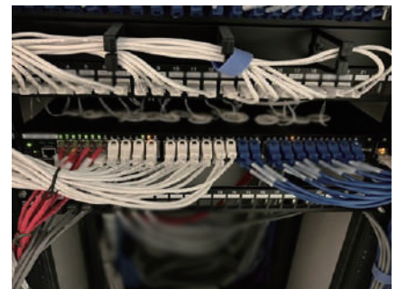
▲無線アクセスポイントへのPoE給電SWとしてEPS室に設置された「DGS-1250-52XMP」
