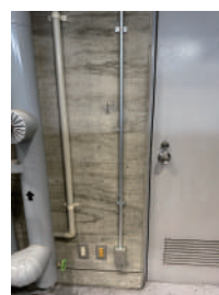
◀ 鉄製の配管で LANケーブルを保護 「DBA-X2830P」
