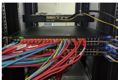
▲ サーバルームに設置されたL3スイッチ(正面)
