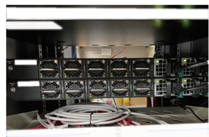
▲ サーバルームに設置されたL3スイッチ(背面)
