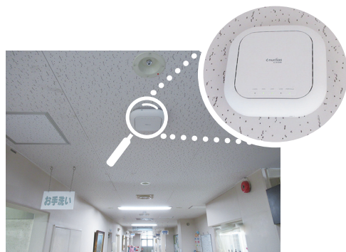
▲廊下の天井に設置されている Nuclias Cloud 対応の無線アクセスポイント「DBA-2520P」
